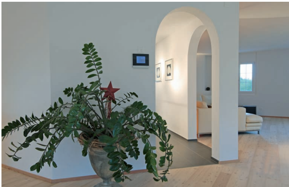
Das Control-Panel von Busch-Jaeger integriert sich sehr schön in das moderne Design des Landhauses. Ohne dieses Panel wäre hier eine üppige Tasterplatte für Licht- und Jalousienbedienung installiert worden.
